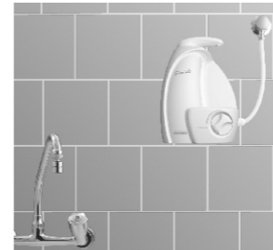
Ponto de filtro e torneira.
